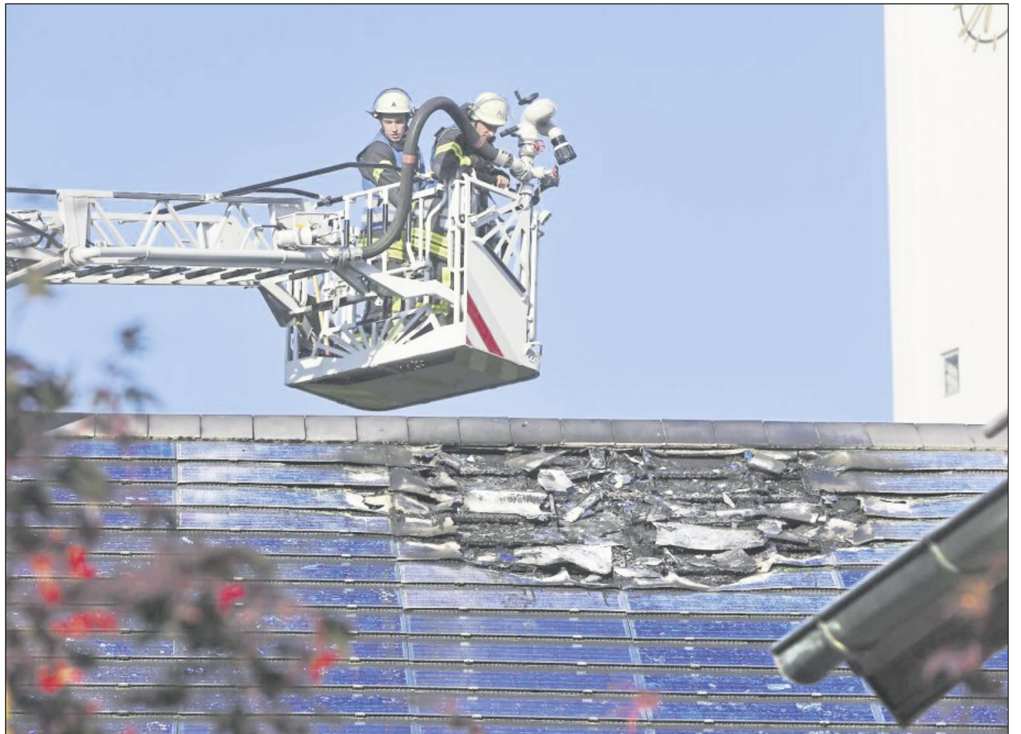
Am Sonntag ist in Plüderhausen eine Fotovoltaikanlage in Brand geraten. Der Alarm kam sehr schnell. Die Feuerwehr konnte deshalb verhindern, dass sich das Feuer stark ausbreitet. Die Brandursache ist noch unklar. Bild: Habermann
